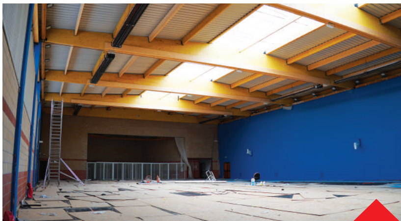
NOUVELLE JEUNESSE ET PRODUCTION ÉLECTRIQUE SOLAIRE AU COMPLEXE SPORTIF FLANDRE, RUE DES GANTOIS
